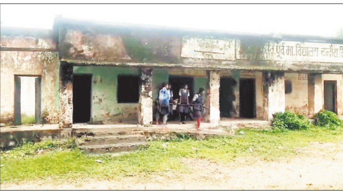
जर्जर शाला भवन।
